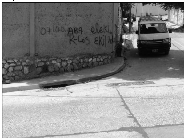
Rue Chavannes. Joints entre sections bétonnées
