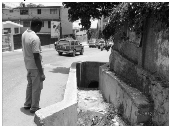
La tête du drain souterrain
