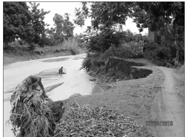
Commencement de nouvelles brèches
